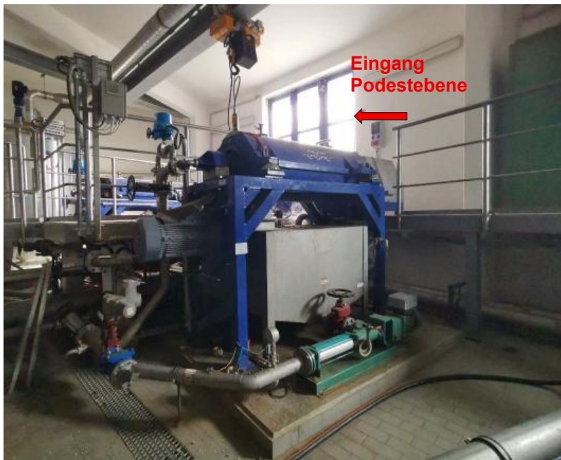
Abb. 6: Eindickzentrifuge Bestand inkl. Dickschlamm-Behälter und DS-Pumpe
